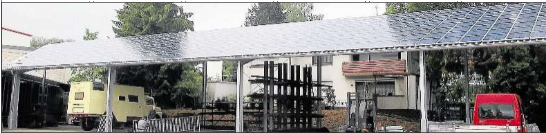
Eine Beispielanlage für Photovoltaikprojekte der Firma AVARIS energy ist auf dem Unternehmensgelände der Firma Filippi-Rützel zu sehen.
